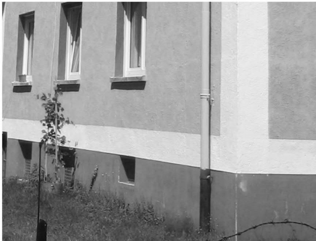
Ungedämmter Keller mit Feuchteschäden
