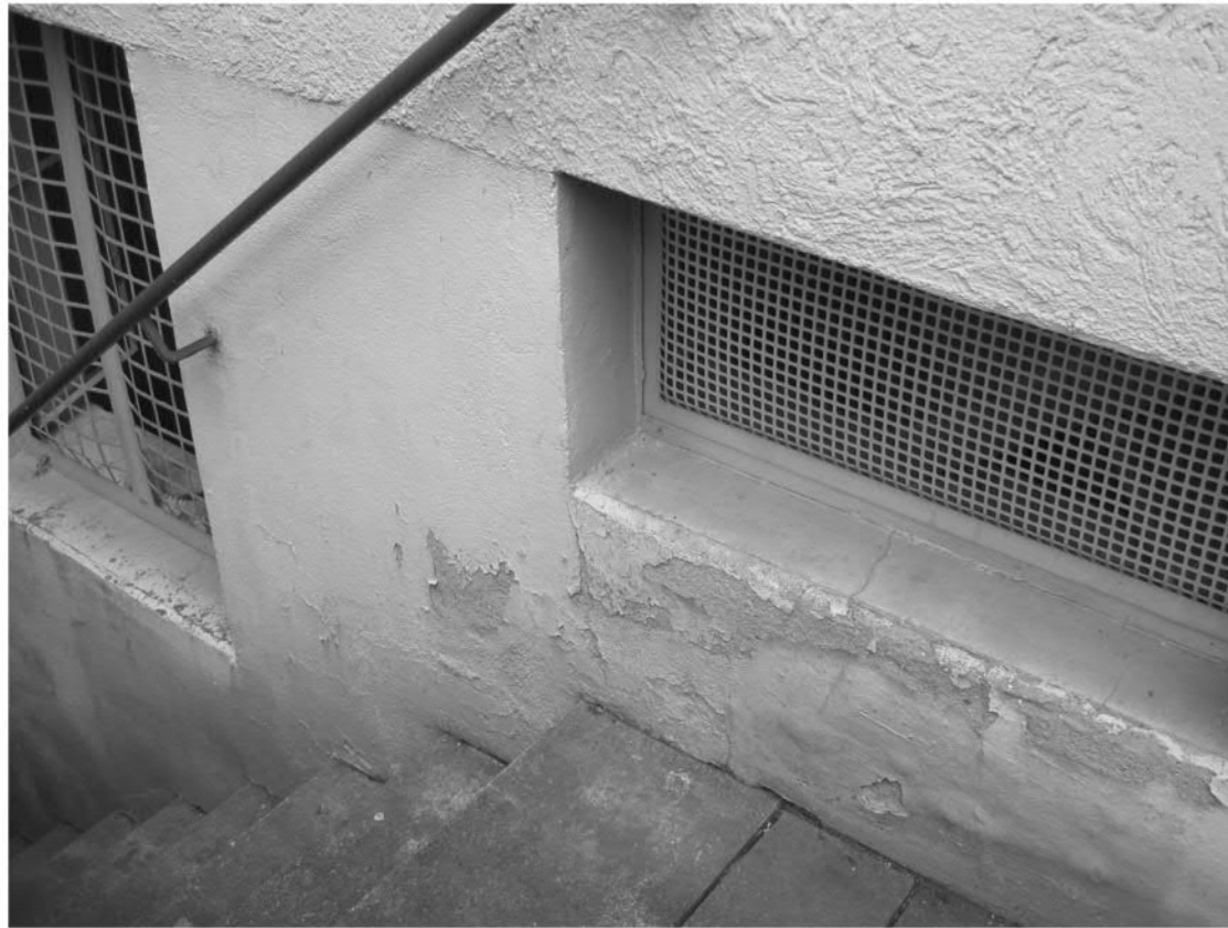
Ungedämmter Keller mit Feuchteschäden
